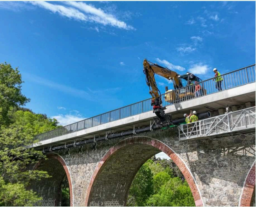
Encorbellement Pont du Duzon · Canalisation DN 800 d'eaux usées · Pont de la STEP d'Acantia.
